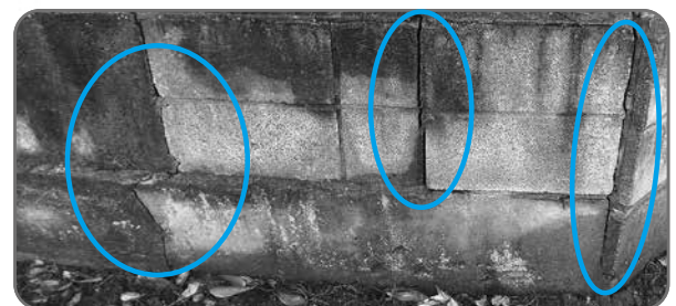
ひび割れの例
