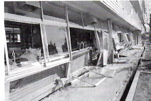
東日本大震災での本宮市被害状況(本宮第二中学校倒壊)
