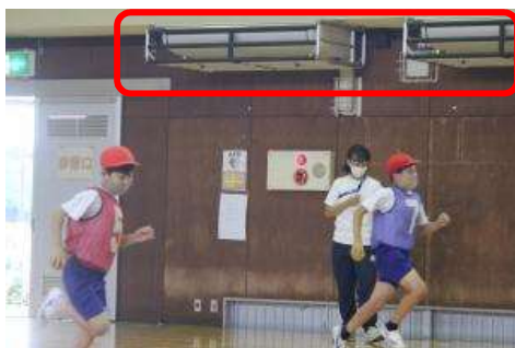
体育館のエアコン
