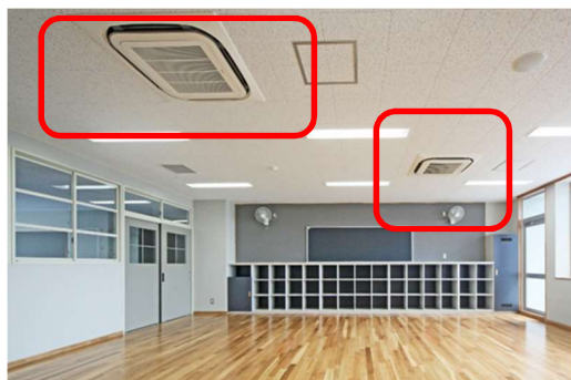
上尾中学校の教室エアコン
