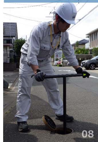
仕切弁の操作
