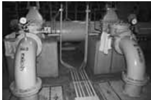
更新予定の本山ポンプ場のポンプ
